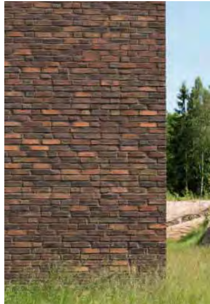
Die gemauerten Fassaden in wilden verbandt treffen direkt auf das Gelände, ein Detail, das für das Zusammenspiel von Gebäude und Natur von großer Bedeutung ist.
