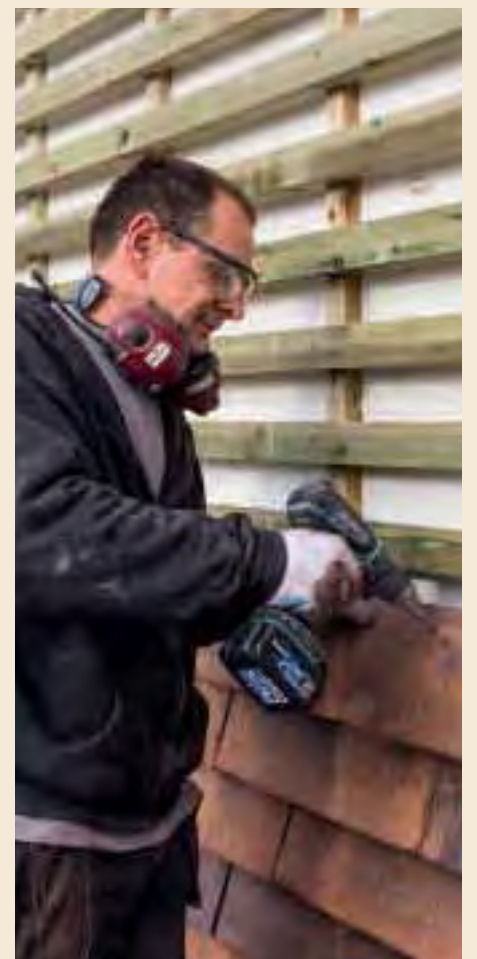
In Slagelse werden neue Dach- und Fassadenziegel an einer rückseitigen Holzkonstruktion befestigt.
