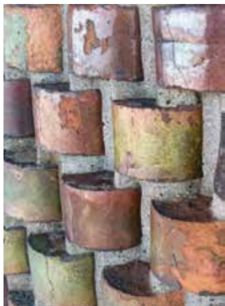
Die oberen Mauerverbände des 140 Jahre alten Kirchturms waren durch Feuchtigkeit geschädigt und mussten ausgewechselt werden.
