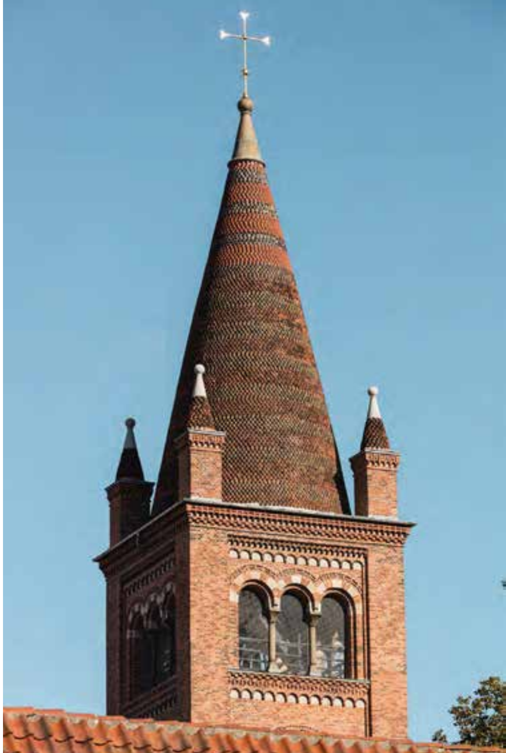
Nach vielen Jahren intensiver und schwieriger Arbeiten konnte die Restaurierung des Kirchturms 2017 abgeschlossen werden.
