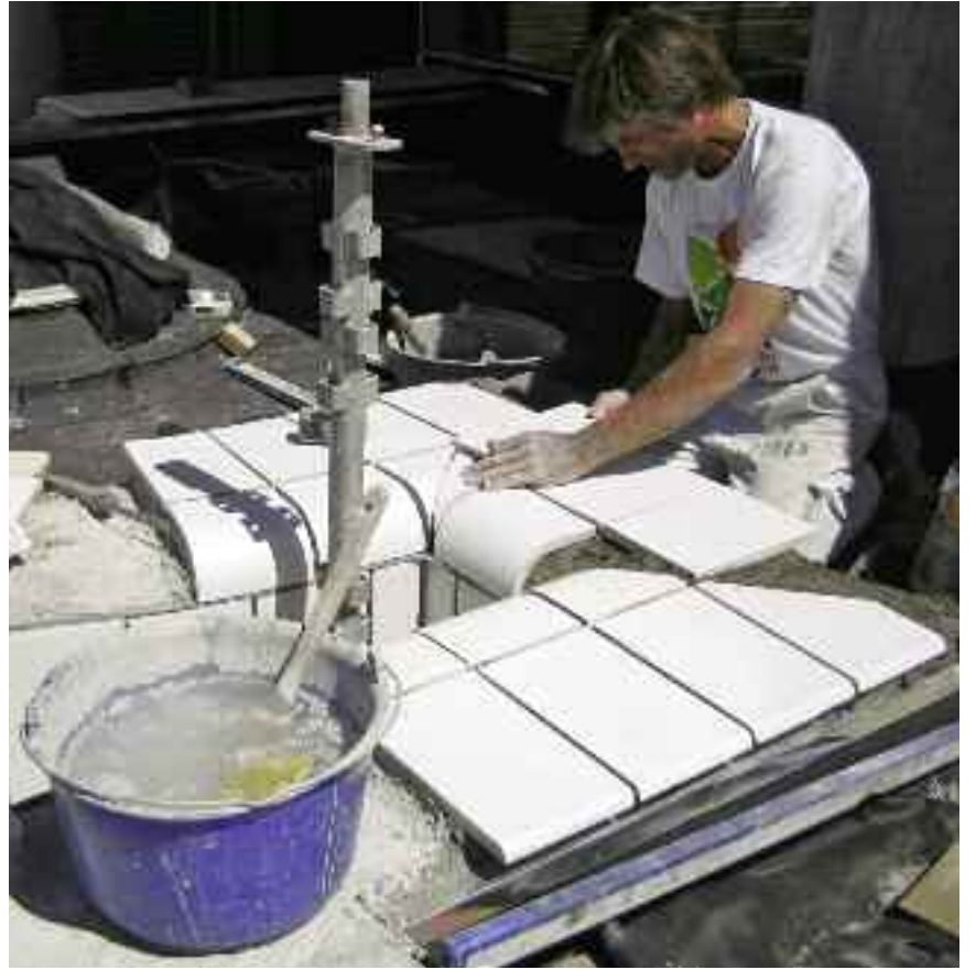
Die Fachleute der Firma Muremester J. Ole Petersen A/S haben vor Ort 4144 speziell angefertigte Fliesen aufgemauert.
