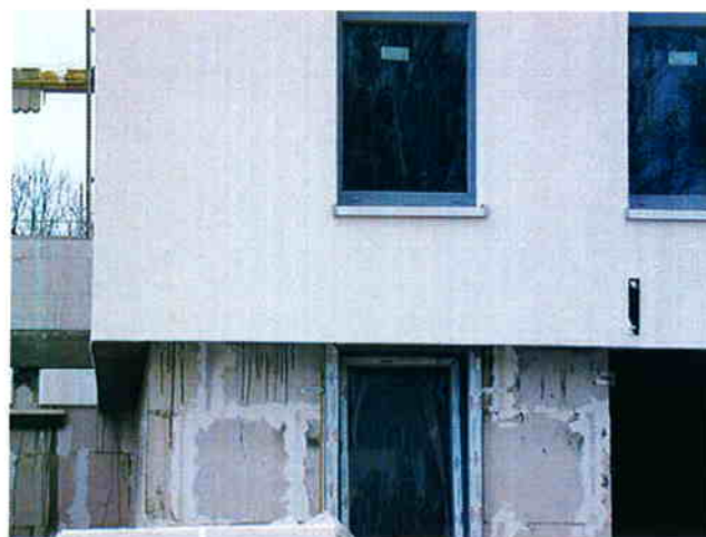
Bild 7. Die große Dämmdicke und die dünne Putzschicht sind maßgebend dafür, dass sich die Putzoberfläche stark abkühlt und unter die Lufttaupunkttemperatur fällt
