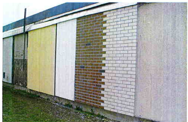
Bild 10. Die auf dem Freigelände des Fraunhofer-Instituts für Bauphysik in Holzkirchen angelegten WDVS-Wandflächen mit Deckschichten aus Putz, roten und weißen Klinkerriemchen
