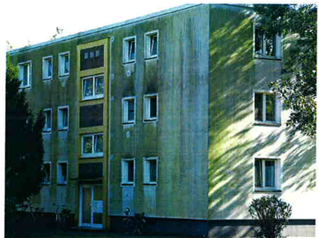
Bild 4. Algenbefall auf der Fassade einer mit WDVS sanierten Außenwand ca. drei Jahre nach Fertigstellung Fig. 4. Alga attack three years after completion of this facade restored with ETICS
